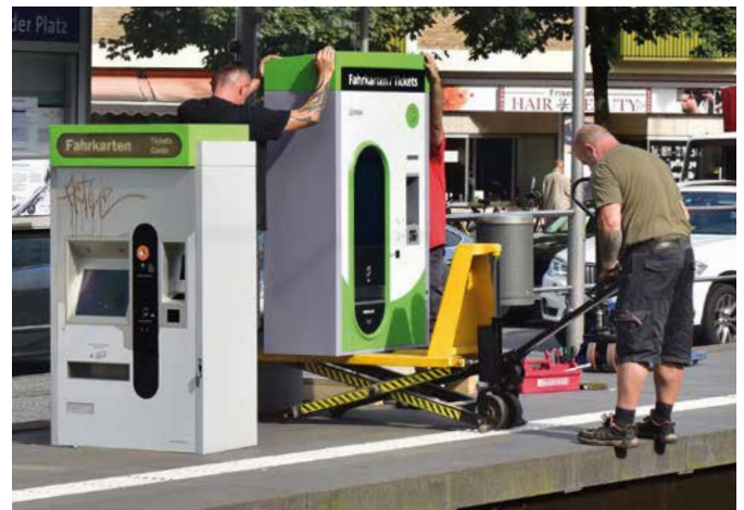
Seite 30 Bei der ÜSTRA in Hannover werden 300 neue Ticketautomaten mit großen Touchscreens installiert ...
